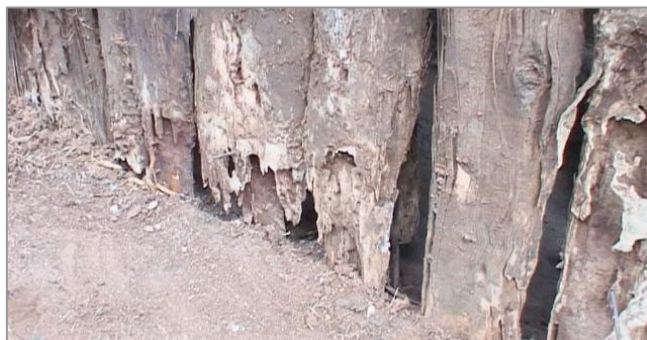
Von Termiten zerfressene Holzmauer
